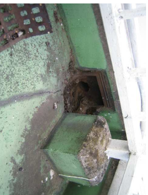
3階漏水箇所ボレン
